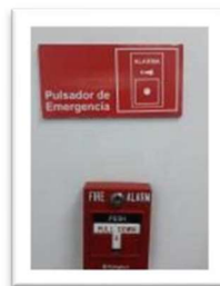
PALANCA DE INCENDIO
